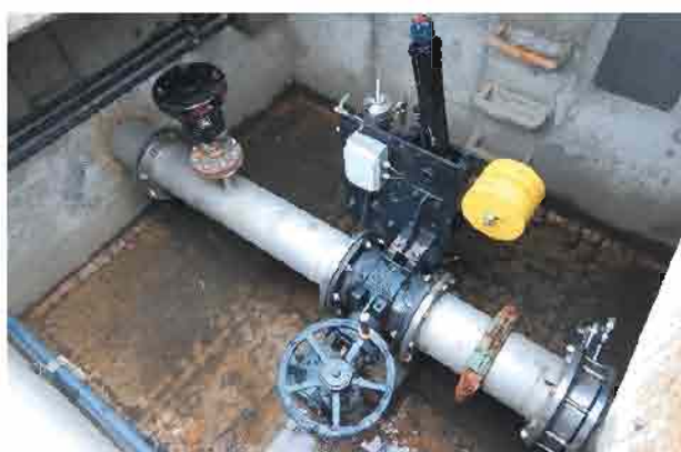
図3.3-6 緊急遮断弁(東部工業団地配水池)
