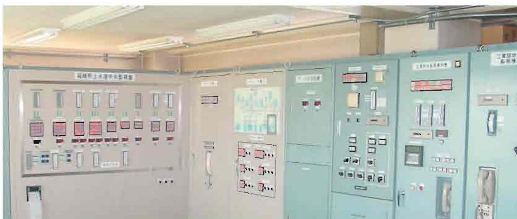
図3.2-3 中央監視施設の制御盤
